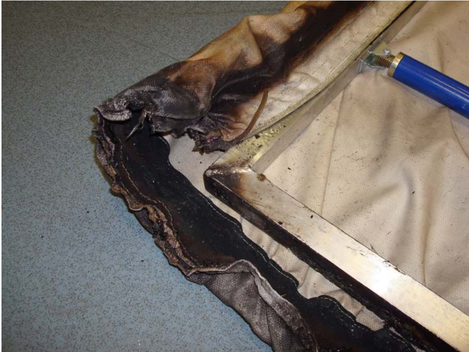
Detailaufnahme vom Rauchverschluss
